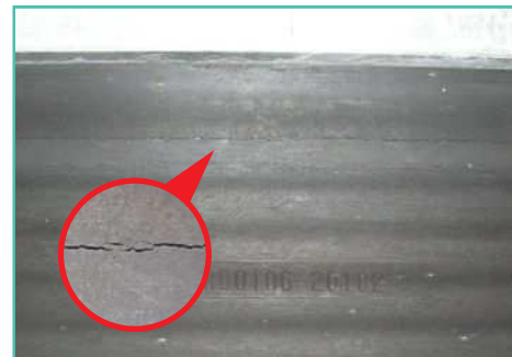
オゾンクラックが発生したゴム支承
